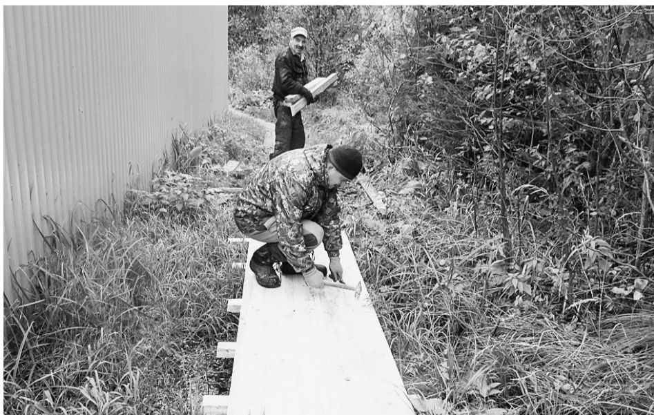
Рабочие заменили часть сломанных и шатающихся досок на новые — надежные и крепкие.
