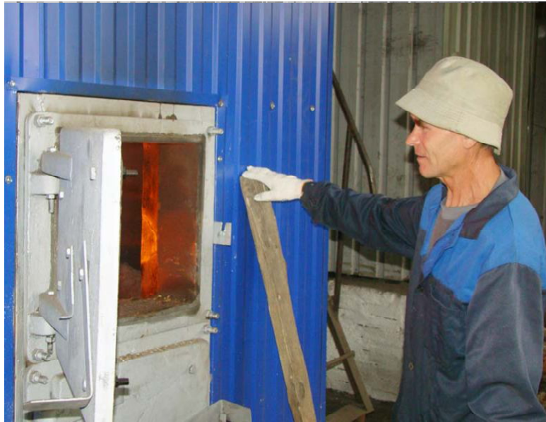
На смене оператор котельной Василий Шабунюв.
