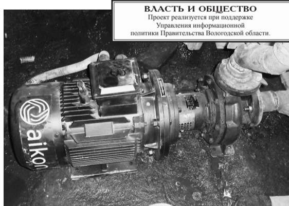
Новый сетевой насос, обеспечивающий циркуляцию теплоносителя в теплосети.
